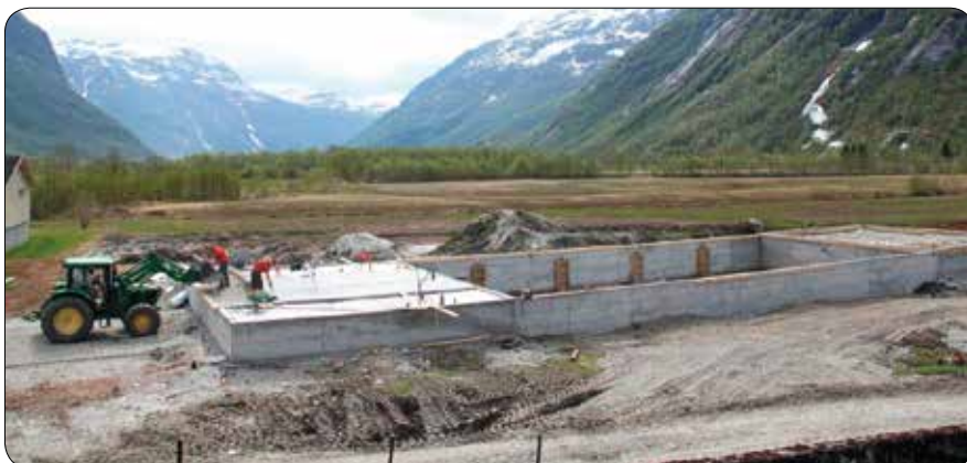
Kurt Heggstad er ferdig med grunnmuren til den nye fjøsen som skal romma 130 mjølkegeiter.
