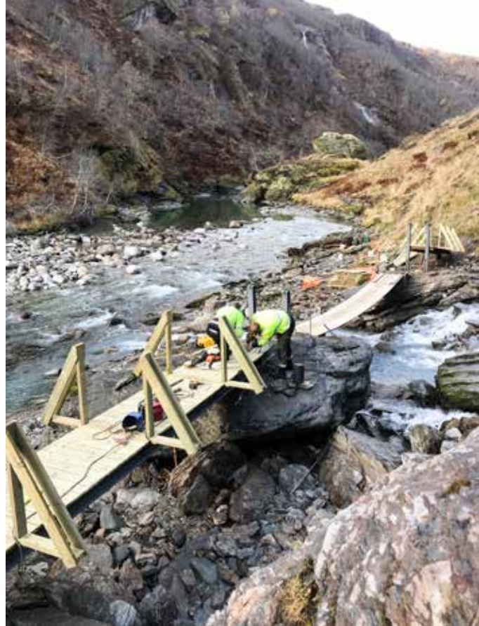
Skjolden bygdeservice i arbeid med ny bru ved Fossen. Foto: Trygve Snotun.
